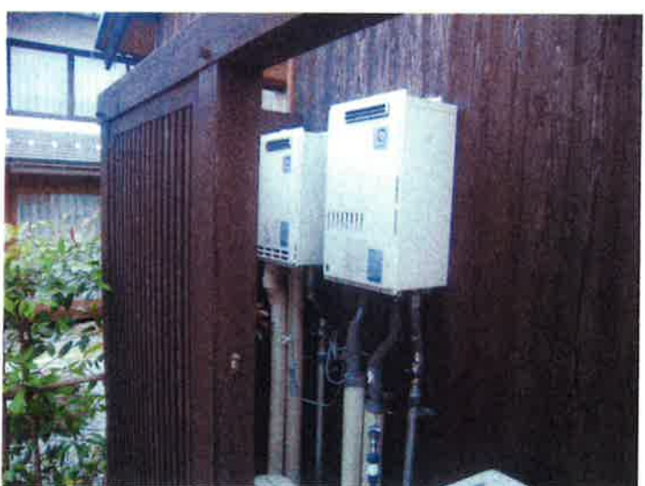
隣の建物 雲・季の部屋 ガス給湯器
